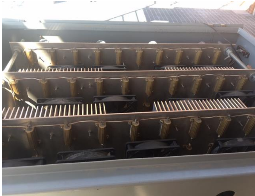
Fig. 2.8. Load Bank-2 Rooftop ERC
