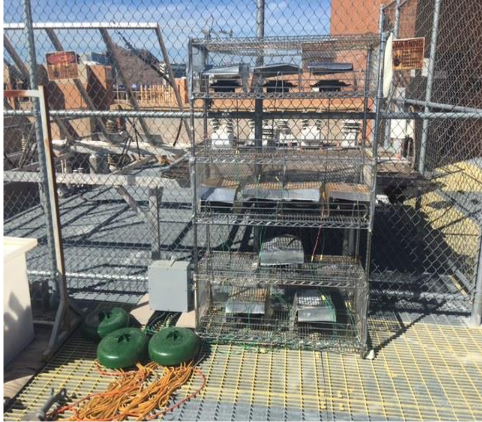
Fig. 2.5. Load Bank-1 Rooftop ERC
